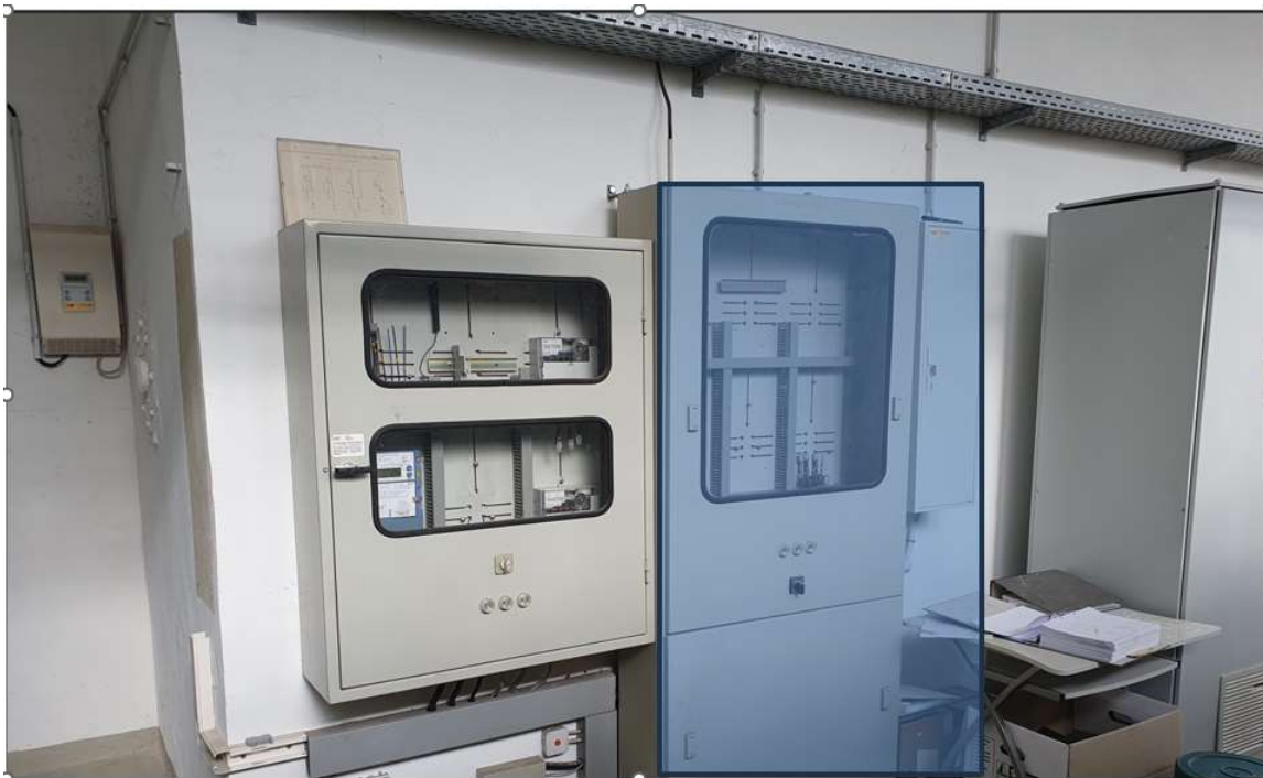
Abbildung 2: Einspeiseschrank in der NSHV
